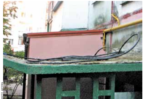
Бухта высоковольтного кабеля лежит на крыше подъезда
